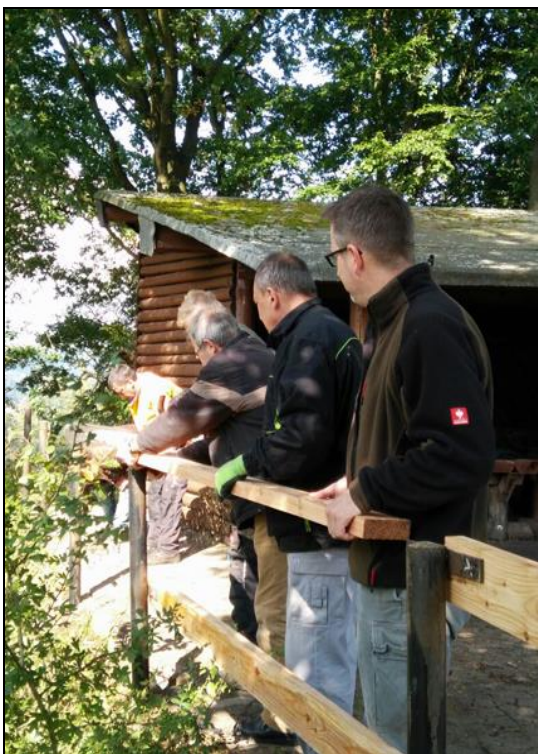
von links: Niclas Hüge, Hartmut Geißler, Otto Hildebrand und Mario Babacz bei Arbeiten zur Montage des neuen Zauns auf dem Grillplatz.
